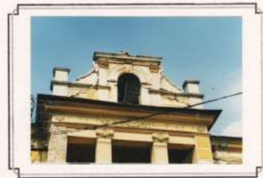
FOTO nr. 32 POȘTA VECHIE Strada București nr. 193, municipiul Călărași, județul Călărași Detaliu fațada principală. Crăpături la frontispiciu și tencuială căzută la coloane.
