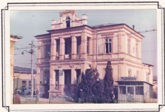
FOTO nr. 29 POȘTA VECHIE Strada București nr. 193, municipiul Călărași, județul Călărași Fațada principală și fațada laterală stânga. Crăpături la frontispiciu.
