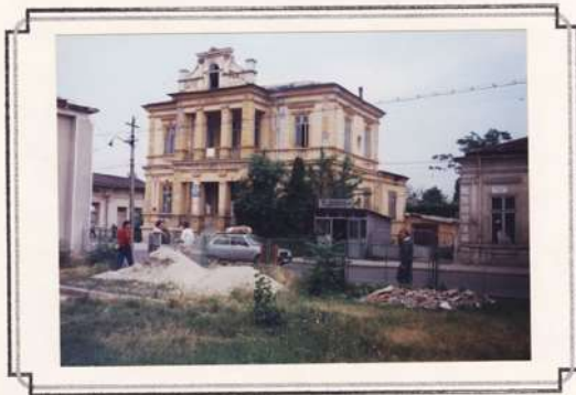
FOTO nr. 30 POȘTA VECHIE Strada București nr. 193, municipiul Călărași, județul Călărași Fațada principală și fațada laterală stânga. Crăpături la frontispiciu.
