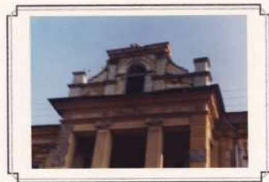
FOTO nr. 31 POȘTA VECHIE Strada București nr. 193, municipiul Călărași, județul Călărași Detaliu fațada principală. Crăpături la frontispiciu și tencuială căzută la coloane.
